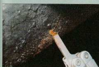
Sous l'antifouling récent, la corrosion menace : un traitement s'impose.
